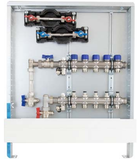
Mit Wasserstrecke W2 K(W+WW)
